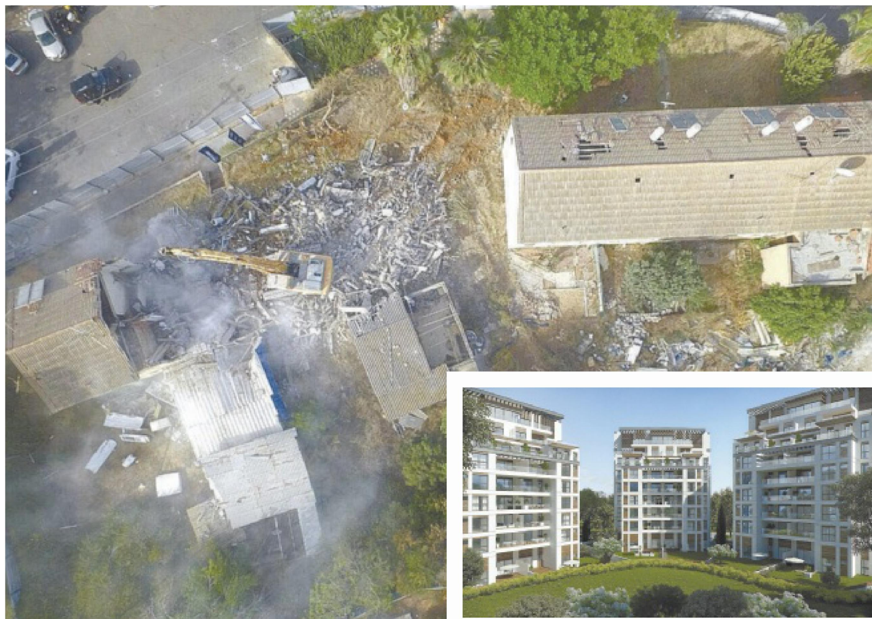
פרויקט פנינוי-בינוי של חברת סרוגו בנס ציונה. 16 מבנים ישנים בשכונת יד אליעזר נהרסו לטובת הקמתן של 402 יחידות דירור צילום: יוסי כהן
